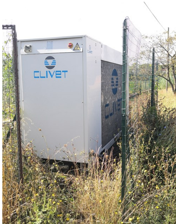
figura 4 – pompa di calore PC1 a servizio Marconcino 1
