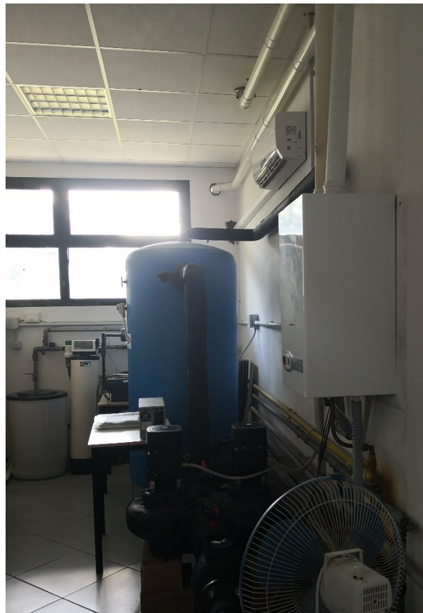
figura 5 - locale tecnico Marconcino 1
