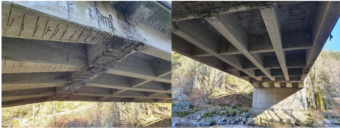
Figura 10. Dettaglio di sella ammalorata e campata centrale del ponte da demolire
