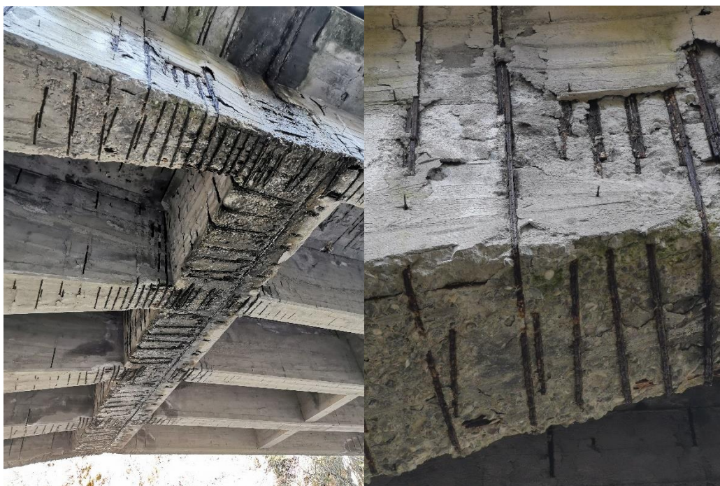
Figura 13. Particolare dello stato della sella Lato VALLE oltre dettaglio di totale assenza di COPRIFERRO.
